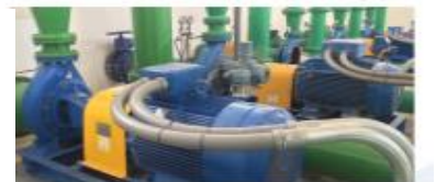
Pumps ขนาดใหญ่ ใช้ High Efficiency Motor
