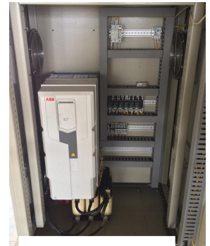
VSD ควบคุม PUMP
